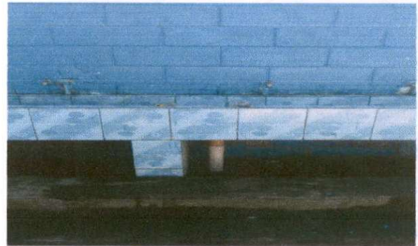
Foto 6: chorros en mal estado
